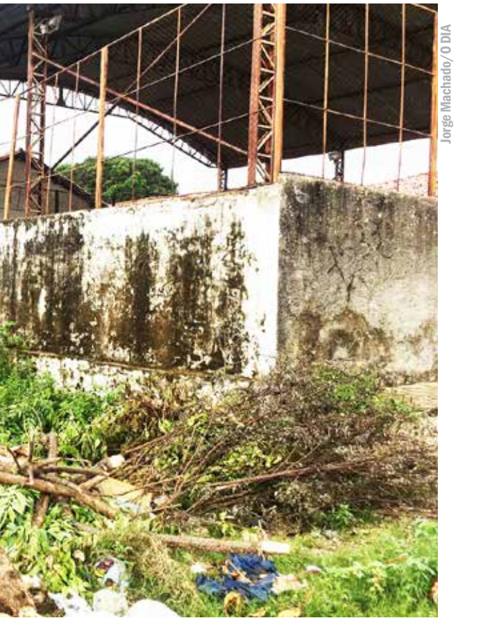
CALÇADA ESTÁ INTRAFEGÁVEL DEVIDO AOS RESÍDUOS
